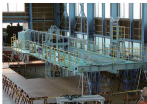
クラブトロリ式天井クレーン (3.5t×20.05m)
