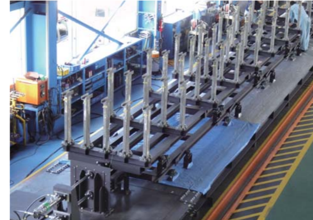
ウォーキングビーム式搬送装置 (高温炉内)
